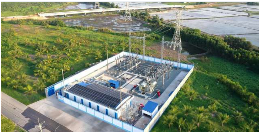
Trạm biến áp 110 kV An Hội đi vào vận hành giúp tăng năng lực cấp điện cho Khu công nghiệp Thành Thành Công.
