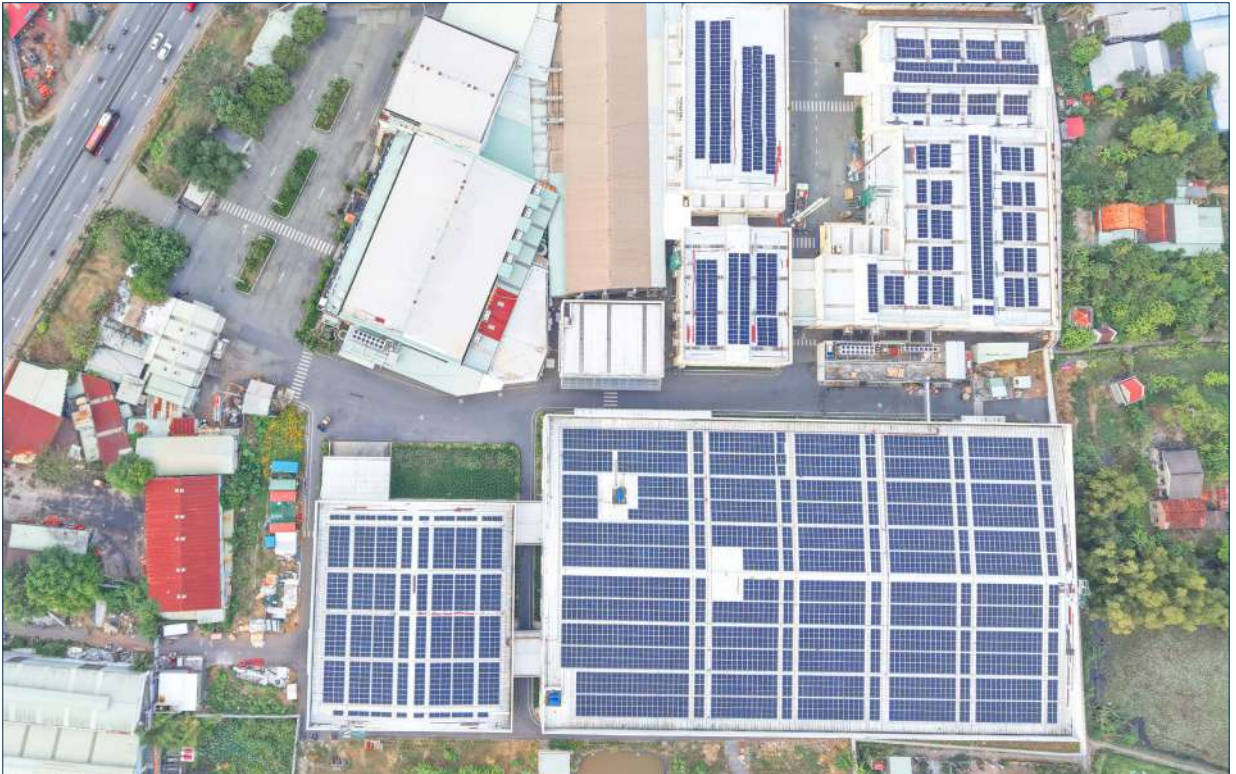
Hệ thống ĐMTMN của nhà máy MIDA công suất 2 MWp do tổng thầu TTC Energy thực hiện.
